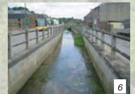
Un végétation non contrôlée s'observe à plusieurs endroits.
